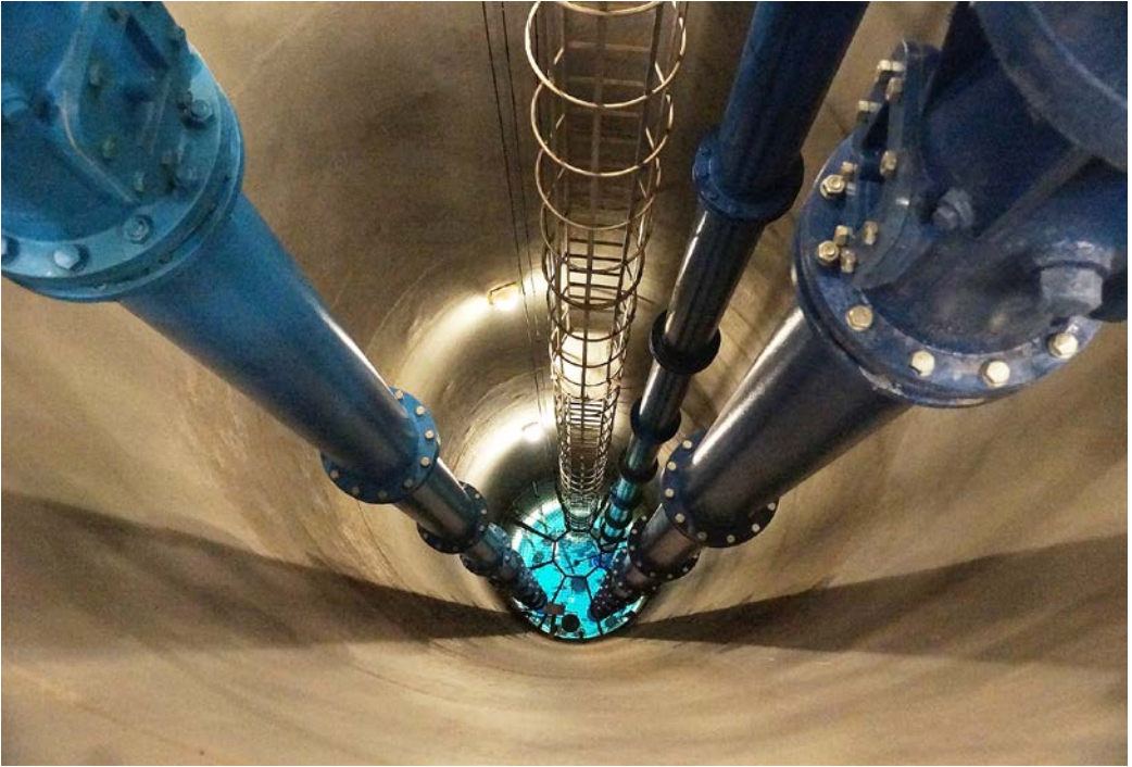
Der Vertikalbrunnen der Grundwasserfassung Hard II in Niederlenz: Die bestehende Transportleitung durch das Bünztal wird mit einer neuen Leitung durch das Reusstal zu einem Ring ergänzt, sodass alle Gemeinden der Region von den Grundwasserströmen im Gebiet Länzert, aus dem die Fassung Hard II ihr Wasser schöpft, profitieren können. (Bilder: ibw)
